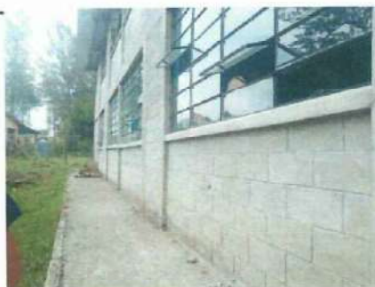
Foto 3: Vista posterior de escuela, banqueta con grietas.
