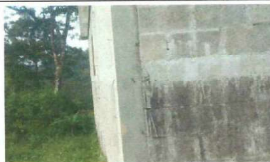
Foto 4: Paredes de cocina sin acabados.
