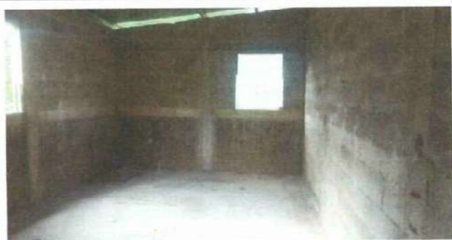
Foto1: Vista interior de cocina sin ventanas y paredes sin acabados.
